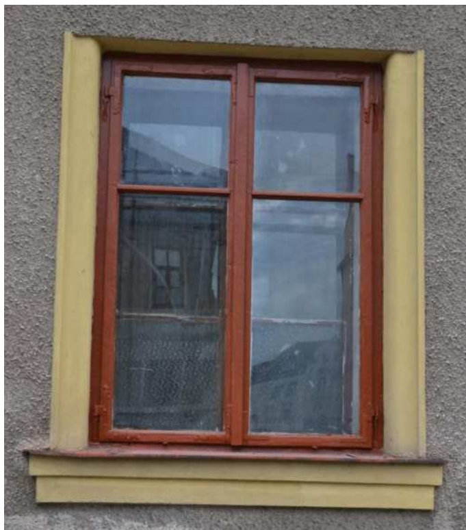
Dům č. p. 13, detail okna se starším typem závěsů na hlavním severním průčelí, foto IP 2013.
